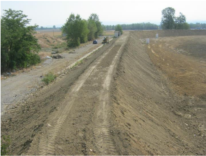
Foto 1 – argine a + 4,00 realizzato sul settore F3 con il 2° stralcio, sul quale si dovrà costruire la sopraelevazione a +7,00
